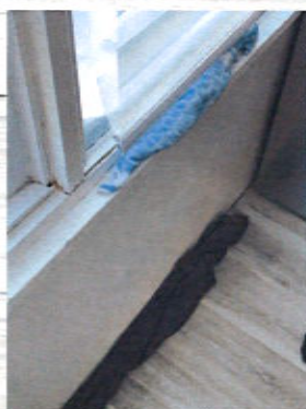
Veel enkel glas met oppervlakte condensatie (Met doeken condensatie opgevangen)
