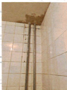
Veel lekkage badkamer via leidingdoorvoer
