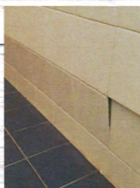
Tegelwerk los door vocht
