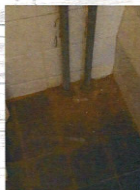
Oorzaak: geen goede afdichting leidingen op douchevloer
